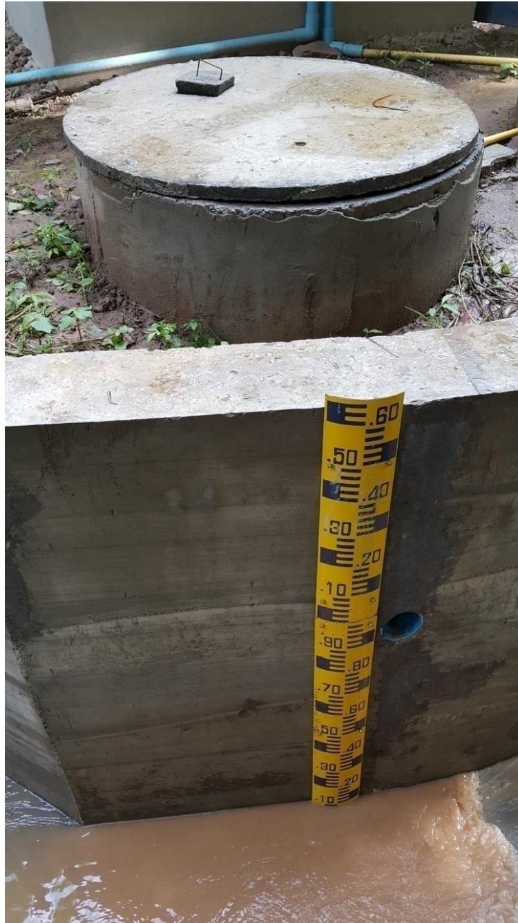
ภาพที่ 6 staff gauge สำหรับสอบทานระดับน้ำและบ่อน้ำนิ่ง (stilling well) สำหรับติดตั้งเครื่องวัดระดับน้ำอัตโนมัติ
